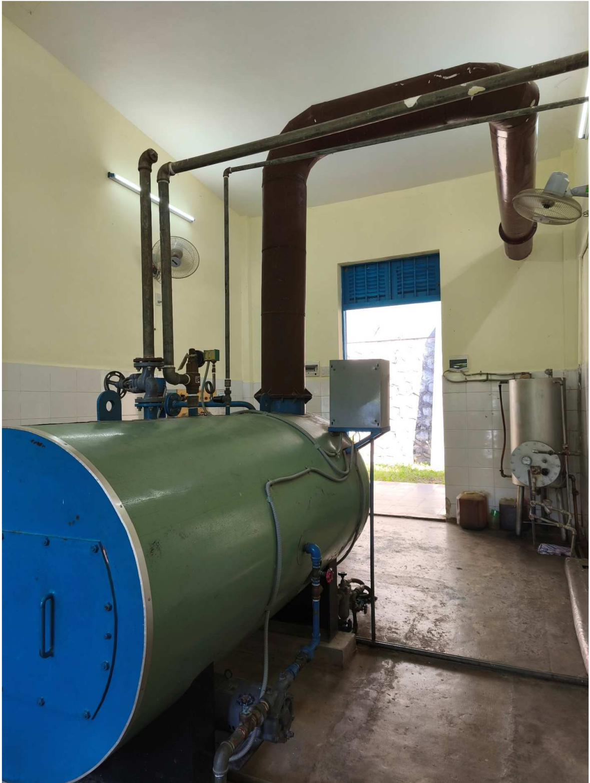
Hình: HỆ THỐNG LÒ HƠI CÔNG NGHIỆP
