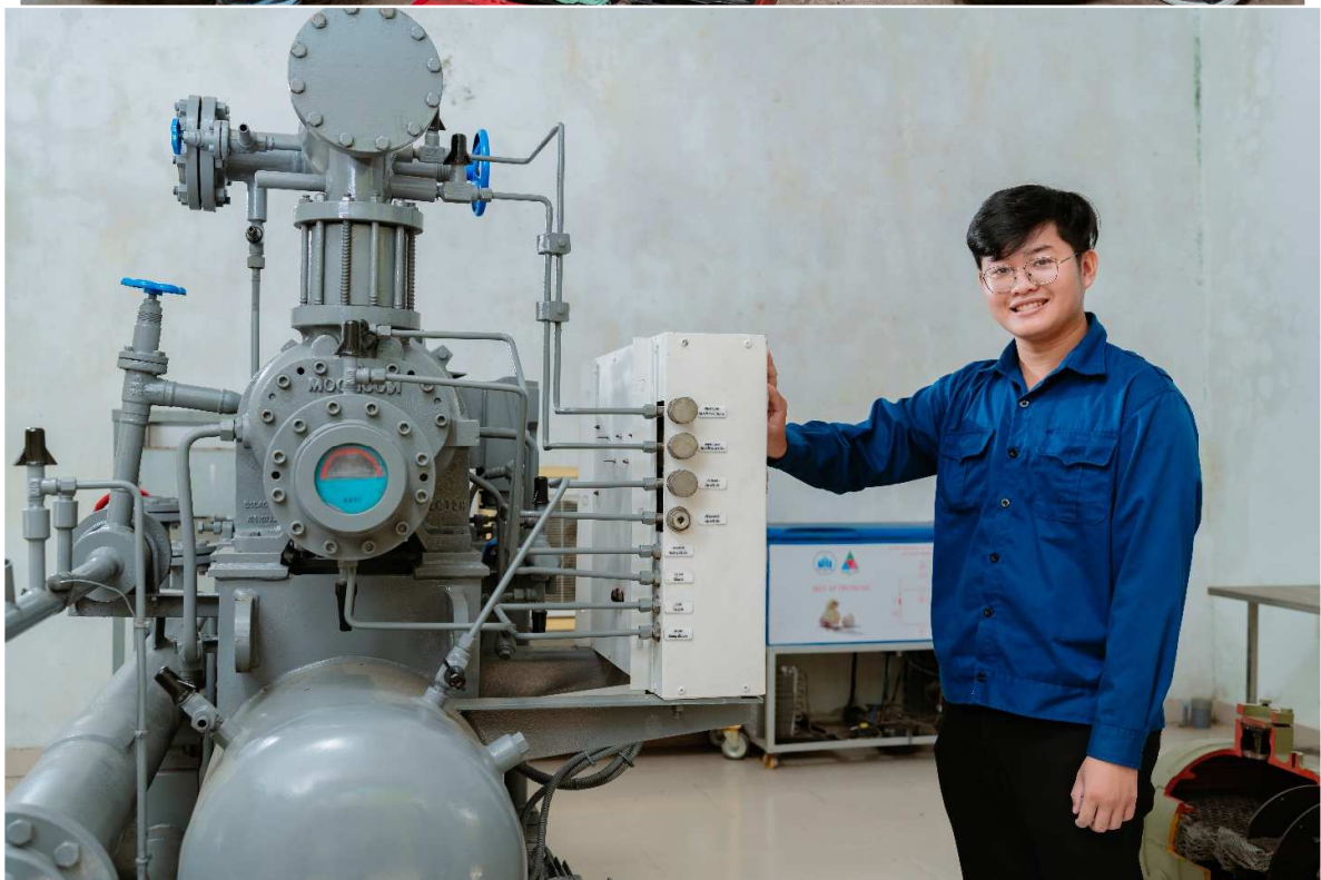
Hình: MÁY NÉN CÔNG NGHIỆP
