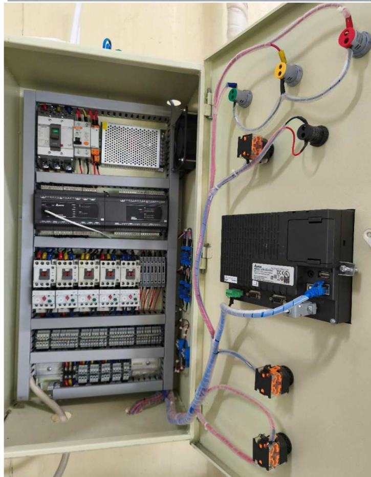
Hình: TỦ ĐIỆN HT LẠNH CÔNG NGHIỆP
