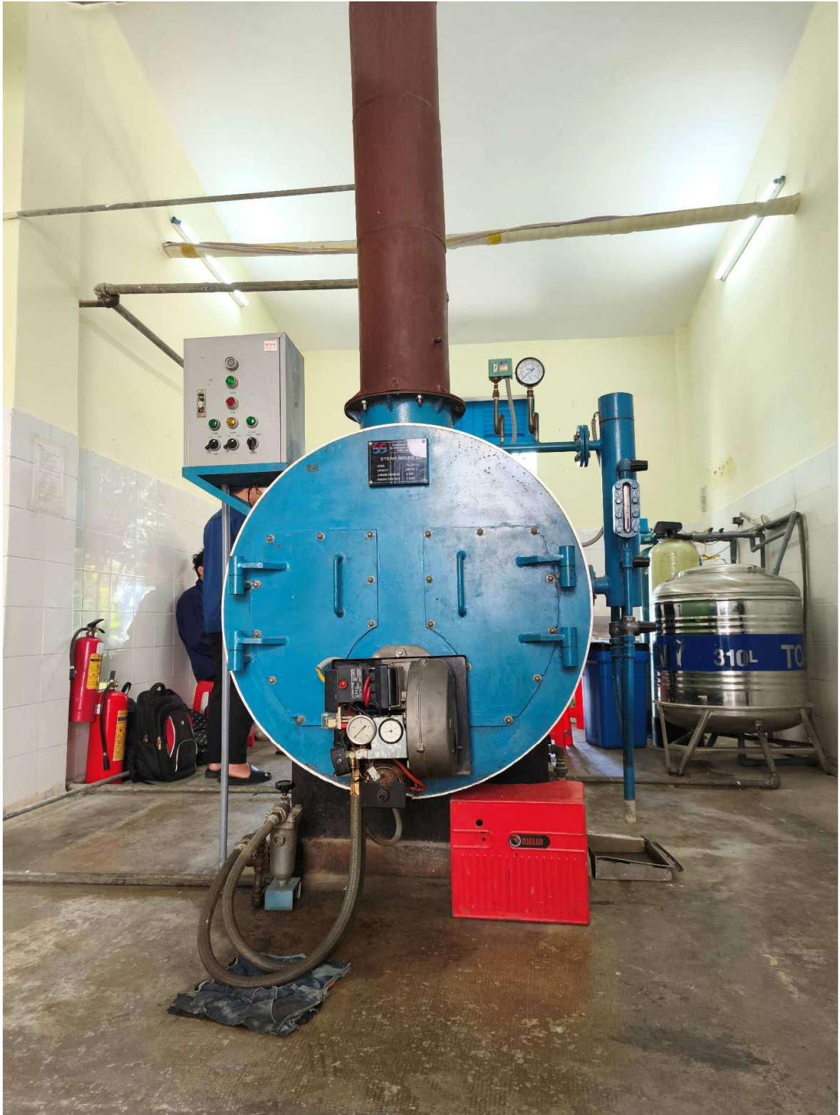
Hình: HỆ THỐNG LÒ HƠI CÔNG NGHIỆP
