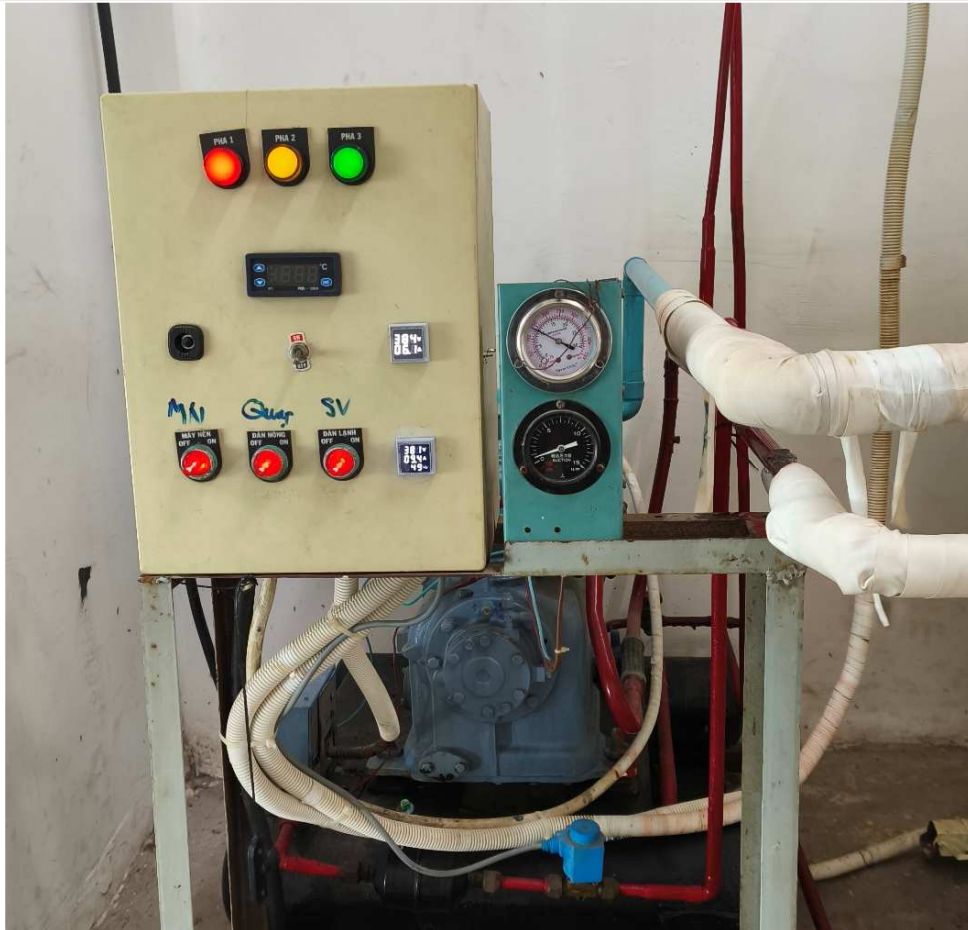
Hình: HỆ THỐNG SẤY LẠNH (ĐANG VẬN HÀNH)
